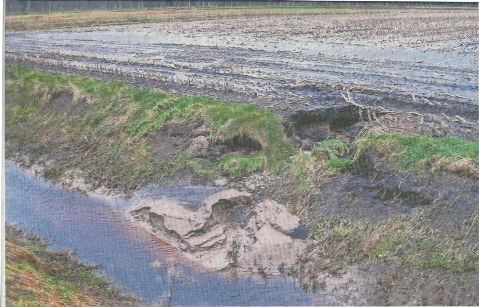
Negativbeispiel: der Graben vor dem Selsinger Moor, Böschungsauskolkung durch zu nahe Beackering und Erosionsrinne.
